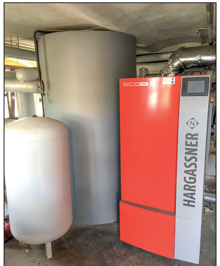
Pellets-Heizung in der Grundschule Altenkirchen
