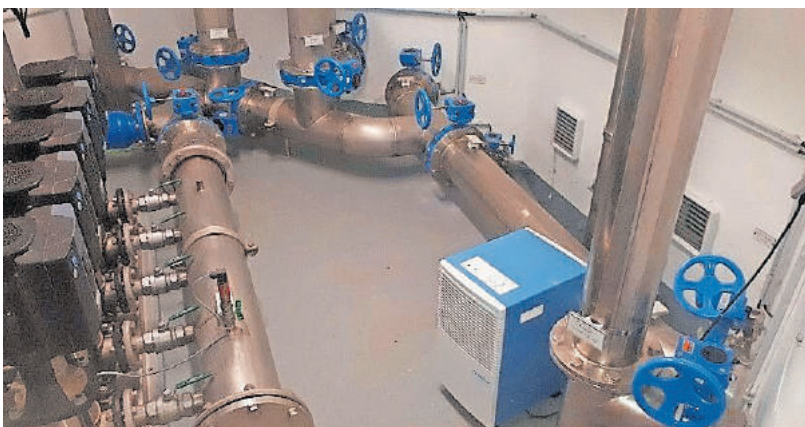
Bild 2: Vorkammer Hochbehälter Schmittweiler, Druckerhöhungsanlage
