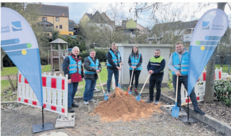
Das Bild zeigt von links: Hubert Zimmer, Thomas Nau, Roger Gerhardt (als Vertreter der Ortsgemeinde Frohnhofen), Marie-Therese Braun (Projektmanagerin Bau DG), Boban Shopov (Bauleiter Libra) und Eric Schardt (Bauleiter DG).
